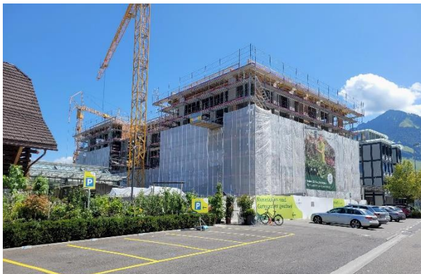
Bild 1: Zielhöhe erreicht: Der Rohbau des neuen Wohn- und Gewerbehouses am Bahnhofplatz 1 in Stans steht.
